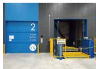
貨物用エレベーター／垂直搬送機
