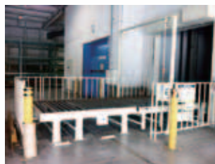
手前:垂直搬送機 奥:荷物用EV
